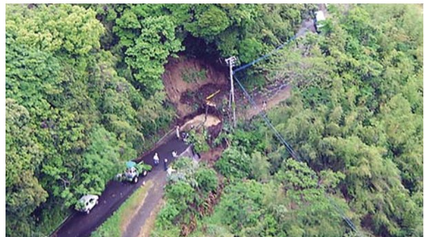
道路脇の土砂崩れ
