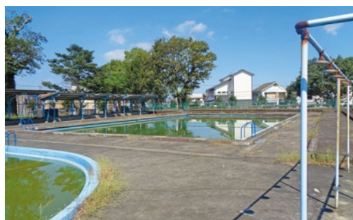
老朽化が進むプール（高山小）
