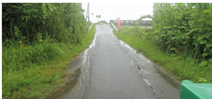
改良が望まれる堤防道
