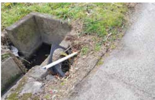
修繕されない場所
