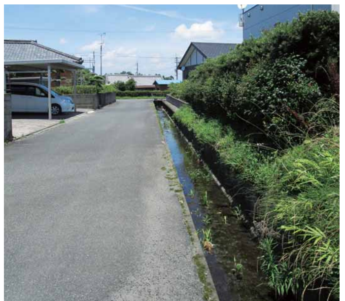
フタのない危ない側溝
